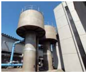
高度浄水処理で安全(明石川浄水場)
